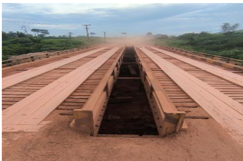
Figura 20 – Tabuleiro de madeira com ausência de pranchas centrais fonte: Almeida,2026
