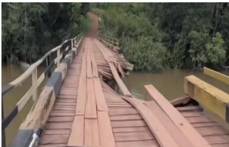
Figura 25 - Ruptura do tabuleiro da ponte do Itapacurá, em Itaituba Fonte: Folha do Progresso (2026)
