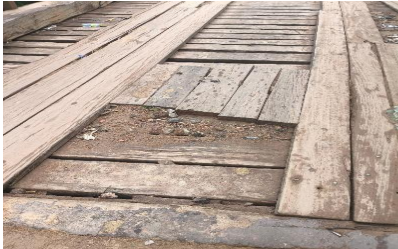
Figura 23 - Tabuleiro de madeira com descontinuidade Fonte: Almeida, (2025)
