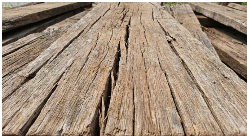
Figura 17 - manifestação patológica de fissuras na madeira Fonte: Almeida, (2026)
